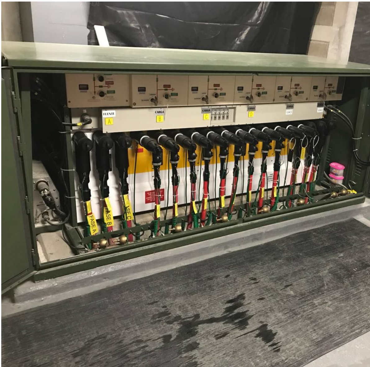
SECCIONADORES EN MEDIA TENSION
